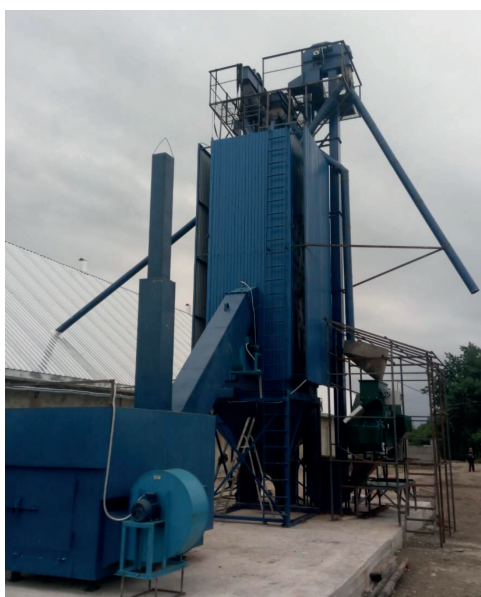
Рисунок 2 – Загальний вигляд зерносушарки з боку теплогенератора
