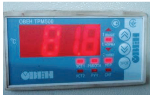
Рисунок 7 – Цифрова індикація температури теплоагента, що подається основним вентилятором від теплогенератора в зернову сушарку
