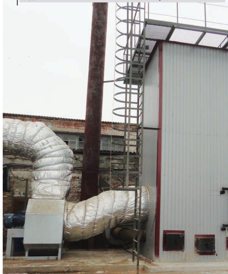
Рисунок 1 - Топка і теплообмінник знаходяться в одному блоці (теплообмінник повітряний вертикальний «КПП-80000»; теплова потужність – до 1,3 МВт ПП «НВТ-Технологія»)
