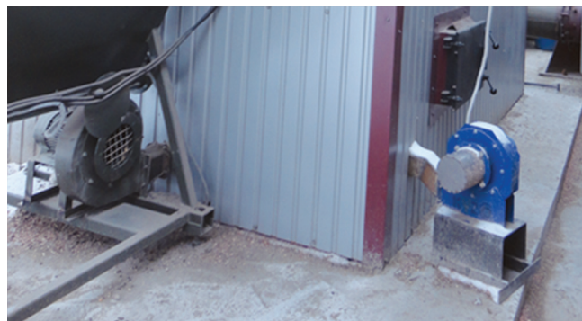
Рисунок 2 — Вентилятори піддуву топки
