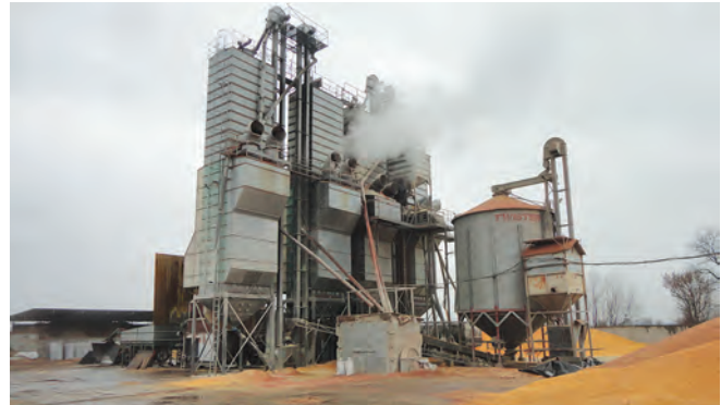
Рисунок 1 – Зерносушильний комплекс, побудований на базі трьох сушарок
