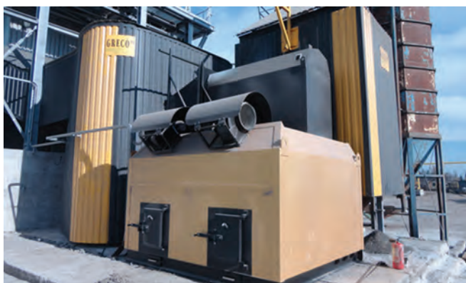
Рисунок 2 – Біотеплогенератор вироблення теплоагента
